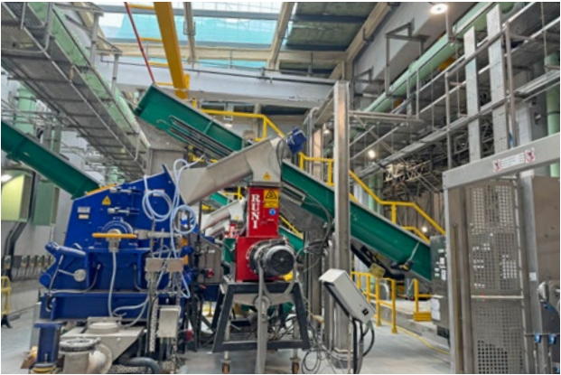
O·Park2引进香港首台锤式破碎机,为厌氧消化前净化和分离有机物提供了全面的解决方案。
